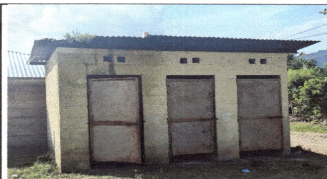
Foto 9. Módulo 4: Sustitución de puertas del servicio sanitario, por deterioro y malas condiciones estructurales.
