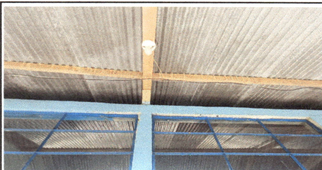
Foto 7. Módulo 3: Se sustituirá el sistema eléctrico del corredor del módulo de aulas.
