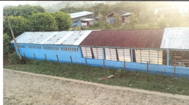
Foto 2: Módulo 1: Evidencia del deterioro de las láminas en las aulas (parte posterior del los módulos a remozar).
