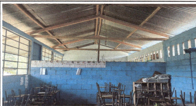
Foto 15. Módulo 7: Mejoramiento de muro de mampostería a módulo del aula de primero B, debido a que al faltar 4 hiladas de block, el ruido pasa fácilmente al otro aula lo que interfiere en el proceso de concentración y aprendizaje de los estudiantes.
